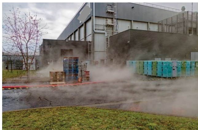
Côté locaux techniques
